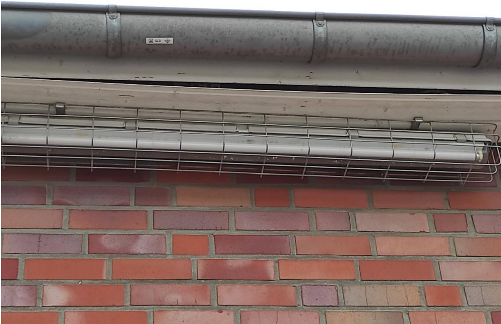
Foto 11: Beschädigung an der Verkleidung des Dachüberstandes des Raiffeisen-Marktes (potentielle Einflugmöglichkeit Fledermäuse)
