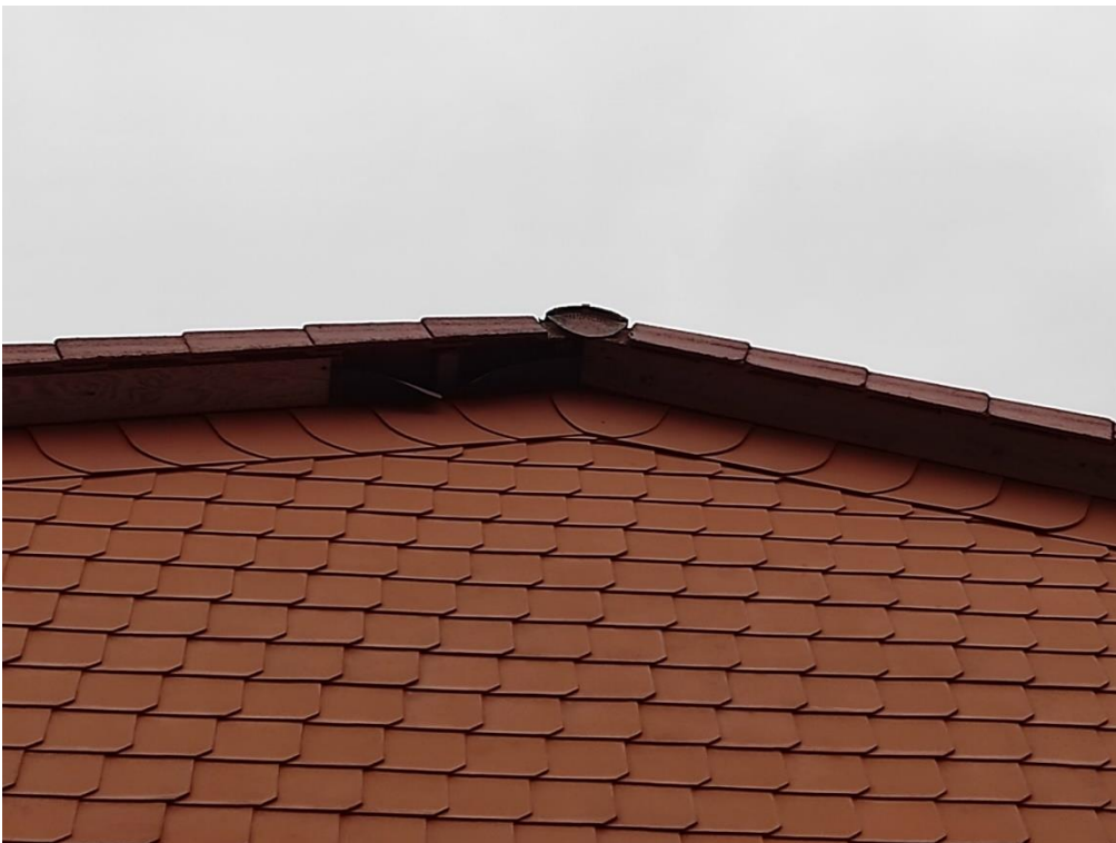
Foto 12: Beschädigter Dachüberstand am Ortgang des Raiffeisen-Marktes (potentielle Einflugmöglichkeit Fledermäuse)
